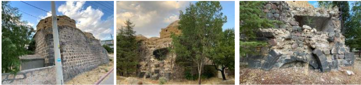
Şekil 6. Hamamlı hamamı güney cephesine yapılan ek, su deposu ve külhan bölümü (Özal, 2022).
